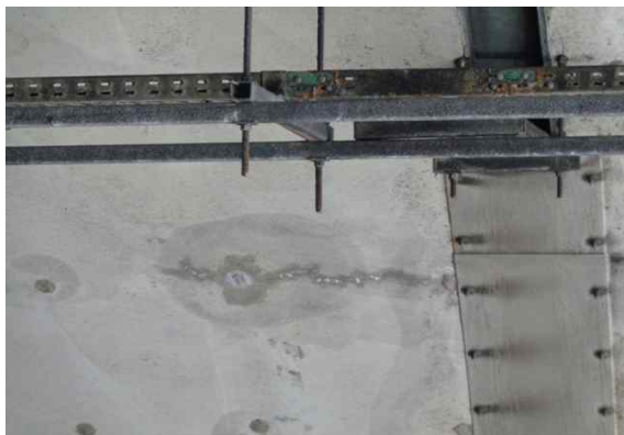
천단부 SPAN.1 균열부 백태
