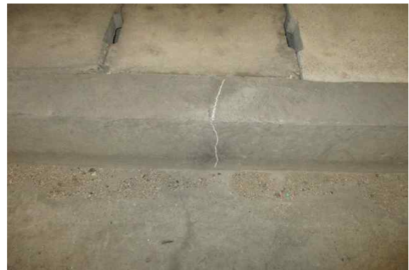
공동구 SPAN.43 균열(0.3mm 미만)
