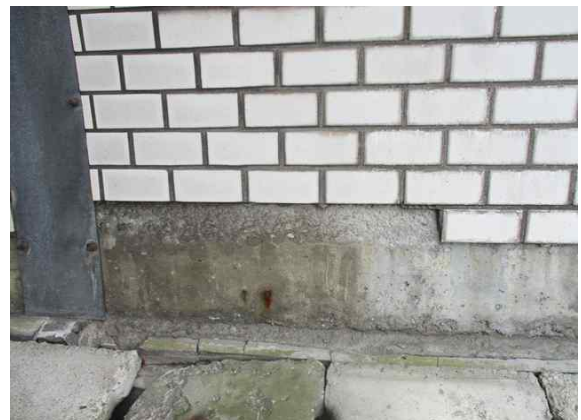
측벽부 SPAN.51 타일 탈락
