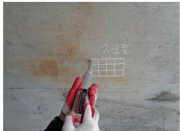
반발경도 측정 현황(측벽부)
