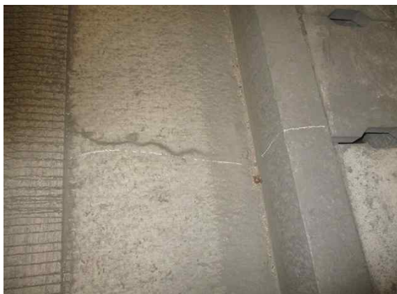
포장부 SPAN.31 균열(0.3mm이상)
