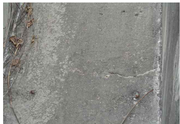
시점부 도수로 균열(0.3mm 미만)
