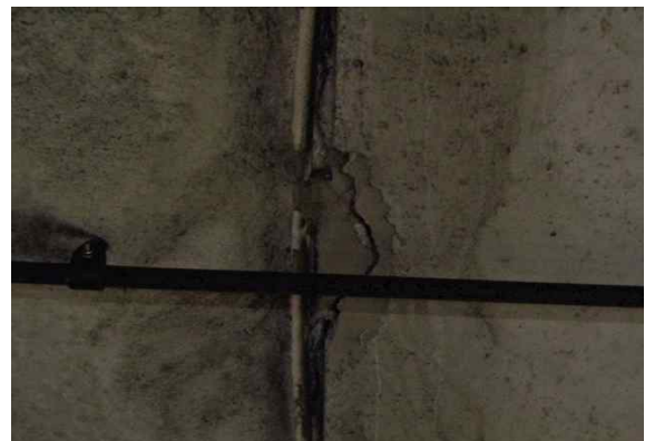
라이닝 SPAN.25 조인트부 박락
