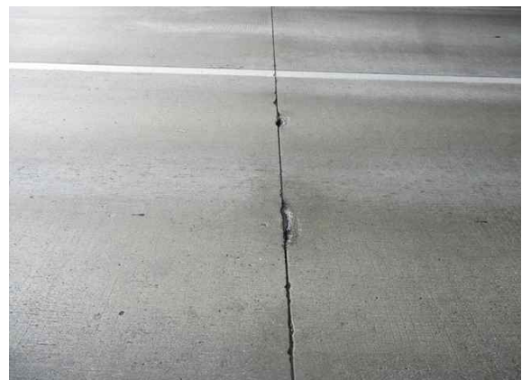
포장부 SPAN.50 파손
