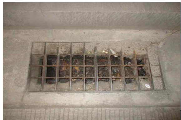
배수시설 SPAN.37 집수구 막힘
