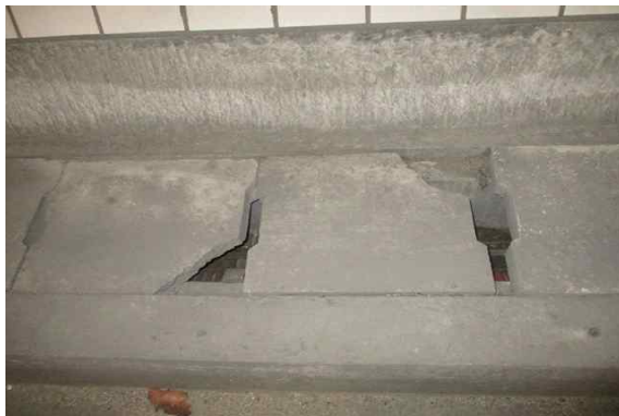
공동구 SPAN.35 덮개 파손
