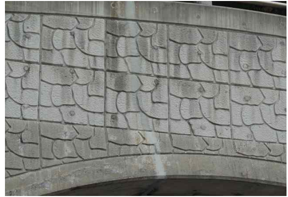
시점부 갯문 균열 보수
