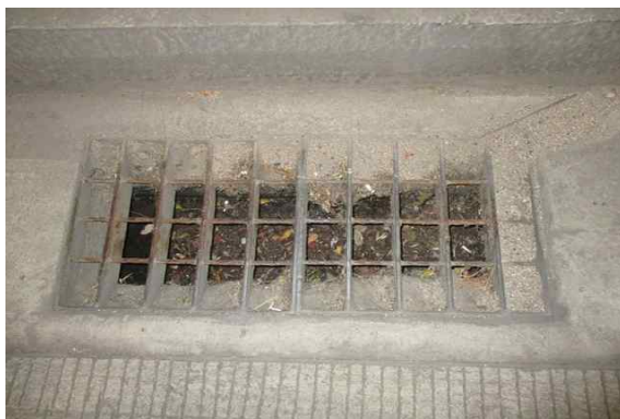
배수시설 SPAN.31 집수구 막힘
