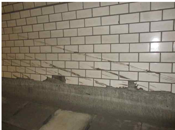
측벽부 SPAN.34 타일 파손
